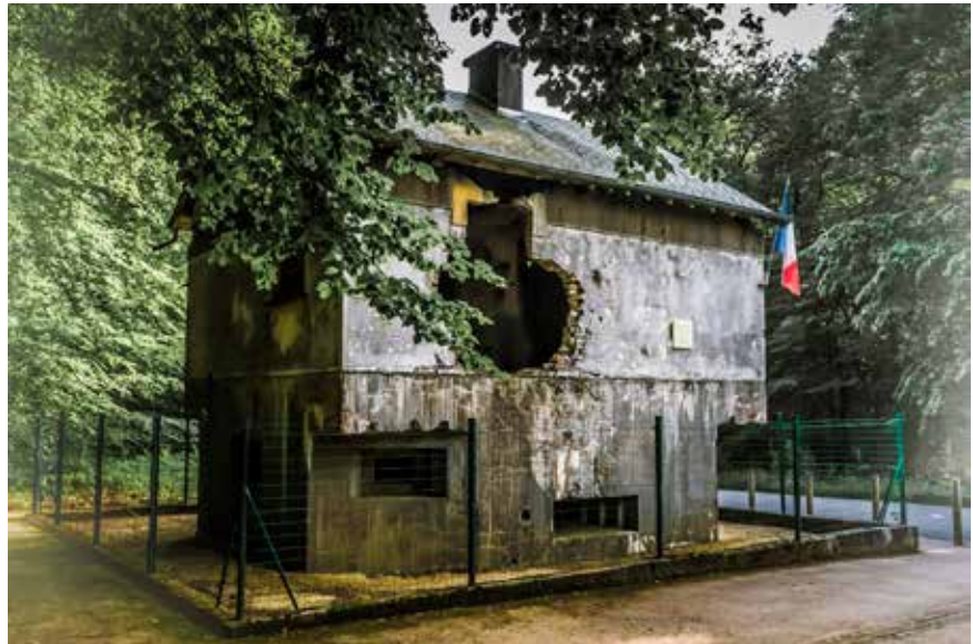
Die Maison Forte «St. Mengès» wurde am 12. Mai 1940 durch die 1. Panzerdivision angegriffen und gilt als Ort der ersten französischen Todesopfer des Zweiten Weltkrieges.
